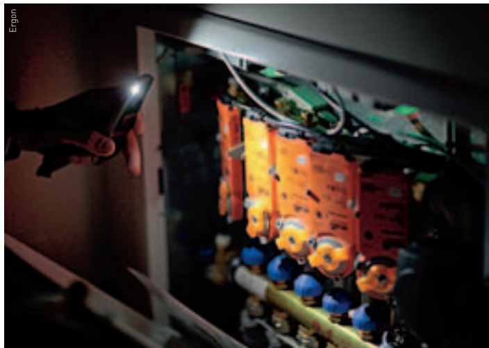
Die Stellantriebe dosieren die Heizung und Kühlung im Gebäude.
