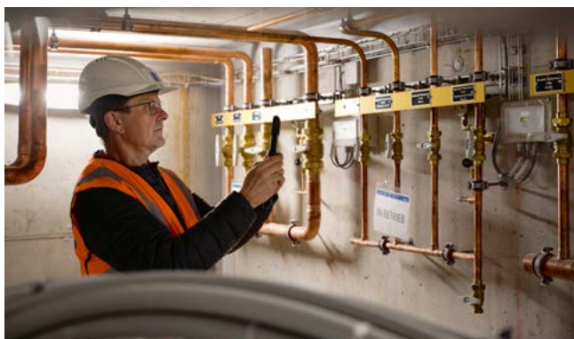
_EIN SCHNELLES FOTO, EIN KURZER BESCHRIEB UND SCHON SIND DER MANGEL SOWIE DESSEN STANDORT ERFASST.
